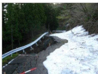
通行止め標識に出ていた崩壊地。帰りには雪は消えていた
